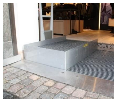
Lift nach oben gefahren, bereit zum Hinauf- /Hinunterfahren
