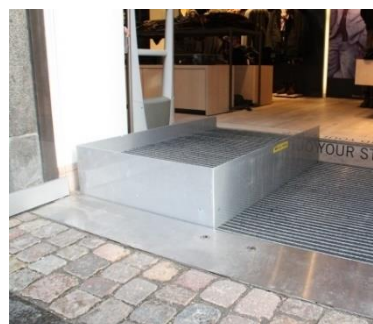
Elevatore al livello superiore, pronto per l'accesso/uscita
