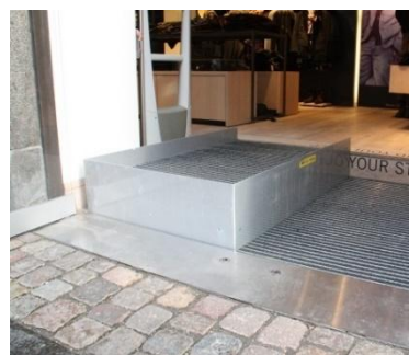
Elevatore al livello superiore, pronto per l'accesso/uscita
