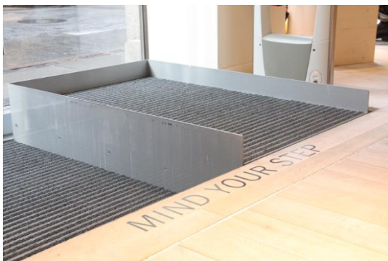
HDN-liften är klar att användas på den övre nivån
